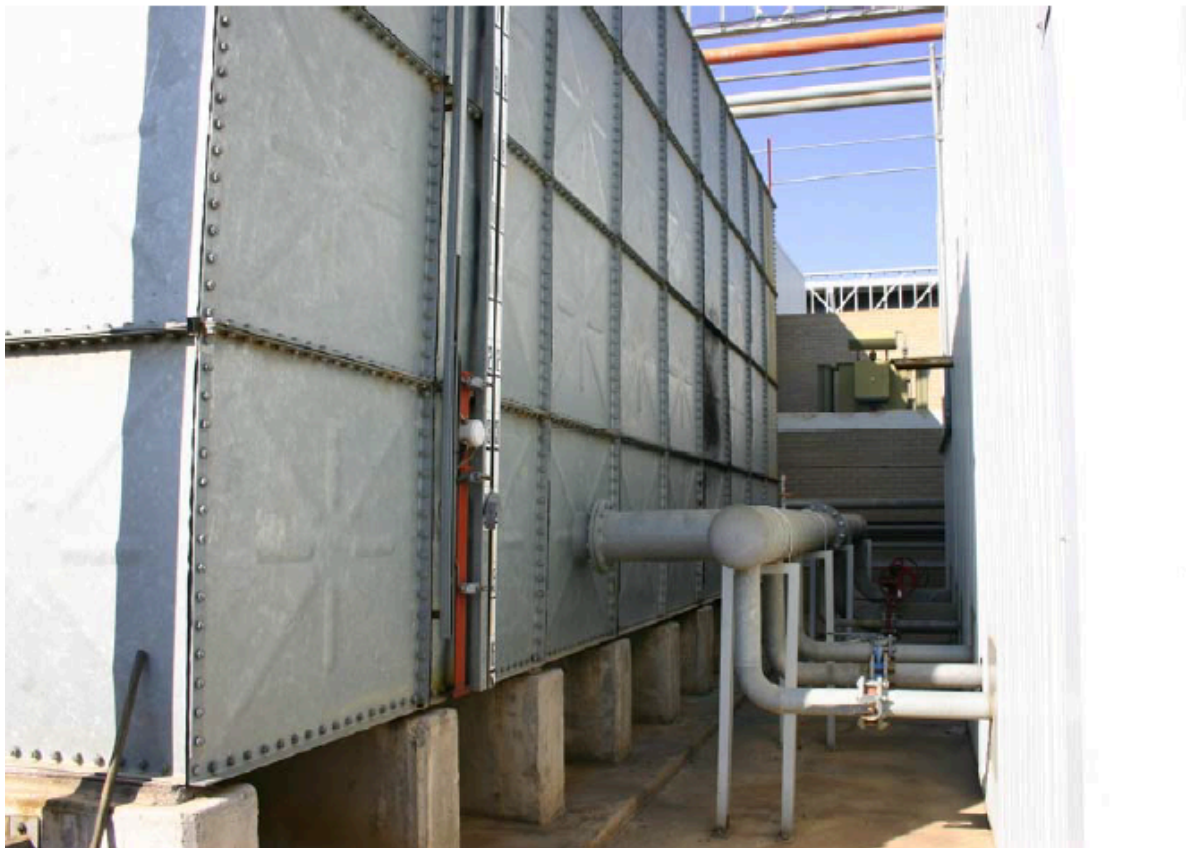
消防系统的水箱
