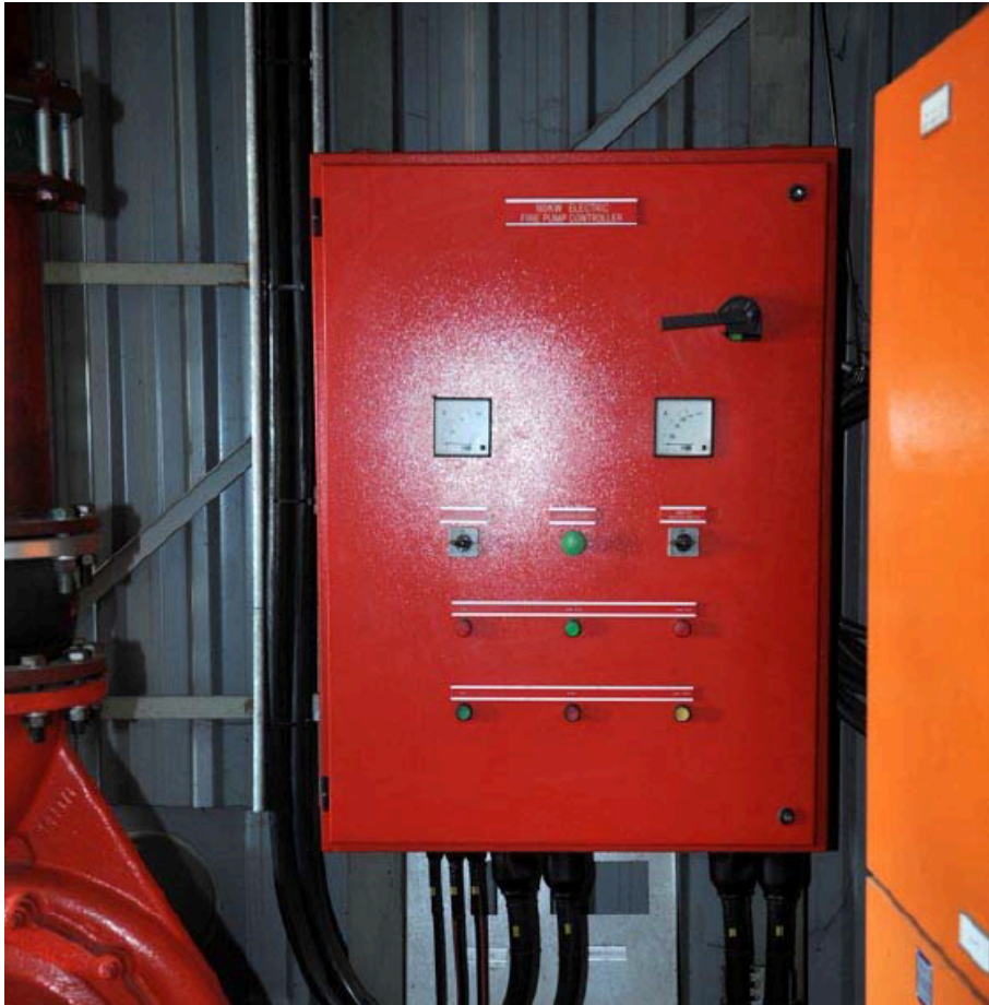
消防泵控制系统
